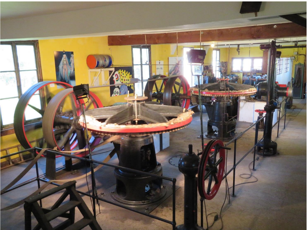
Avec deux turbines immergées pour production d'électricité
